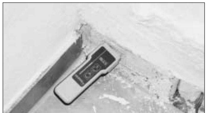
Abb. 3: Maximale Sättigung der Oberflächenfeuchte mit 99,9 % HFÄ. (Tiefenfeuchtemessungen (nicht abgebildet) mit Klimasonde identifizieren ursächliche defekte vertikale Abdichtungen der erdberührten Außenwände).
