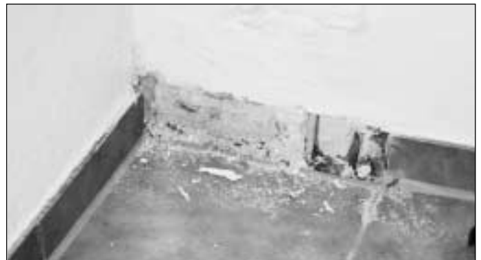
Abb. 2: Erst nach Öffnung des Fliesensockels wird das Schadensausmaß und zudem ein mikrobieller Folgeschaden mit Mykotoxin-bildenden Schimmelpilzen Aspergillus flavus , A. versicolor und Acremonium strictum erkennbar.
