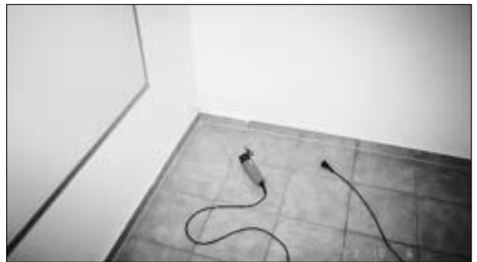
Abb. 1: Wohnungsflur im UG als Zugang zu Schlafzimmer, Bad und Kinderzimmer erscheint unauffällig, obwohl großflächige Feuchteschäden (> 10,0 qm) im Fußboden und an Außenwänden vorhanden sind.
